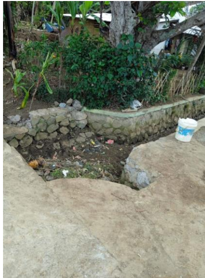
Gambar 1. Kondisi Saluran Irigasi di Dusun III Desa Bayongbong
